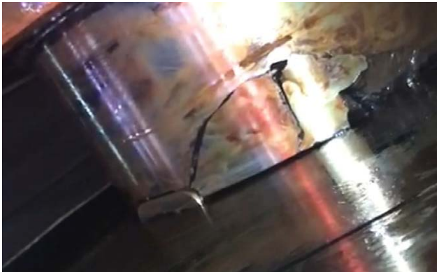
شکل ۱۱: ترک در شفت گیربکس ۴۸۰-۰۰۰ پس از انتقال به کارگاه و دمونتاژ آن
